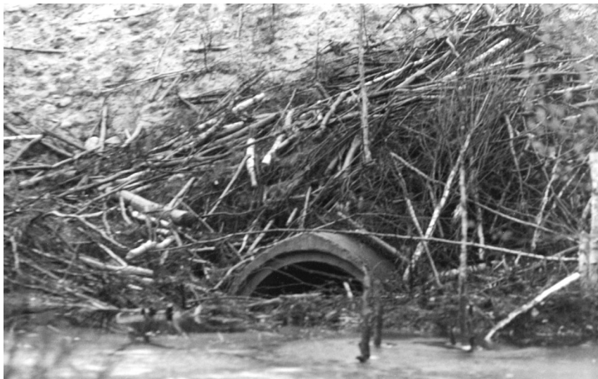
Рис. 41. Дренажная труба под железнодорожным полотном, перекрытая бобрами (фото Ф. Федорова)
